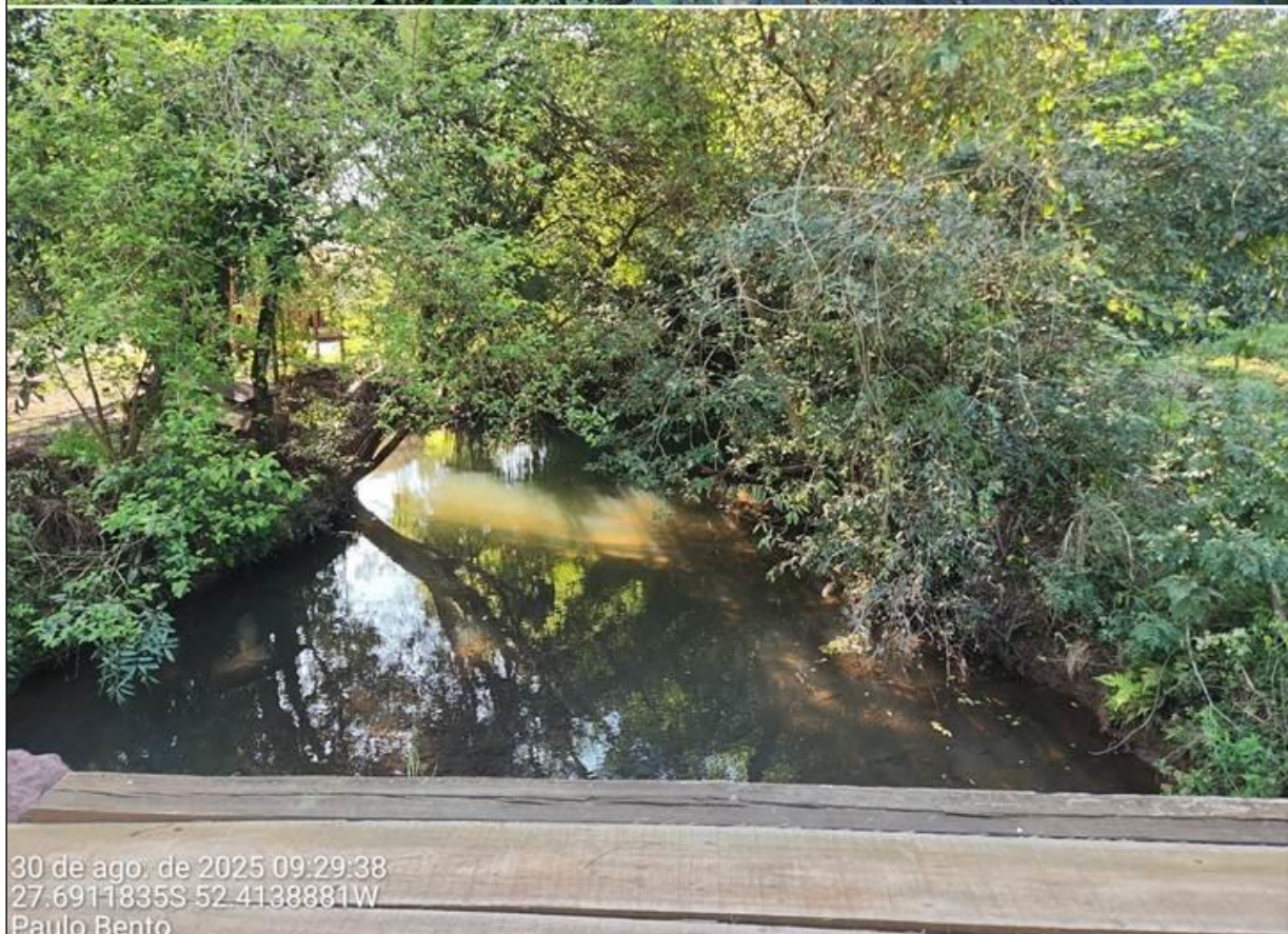
Figura 4- Registro Fotográfico de campo do Ponto 03 (Ponte 03) evidenciando a secção transversal do rio e a ponte existente em situação precária.
